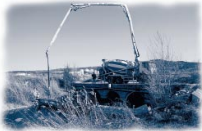
foto: Borut Mozetič Betonarna Rokava nam je nudila pomoč pri sanaciji zaporničnega sistema na Ari.
